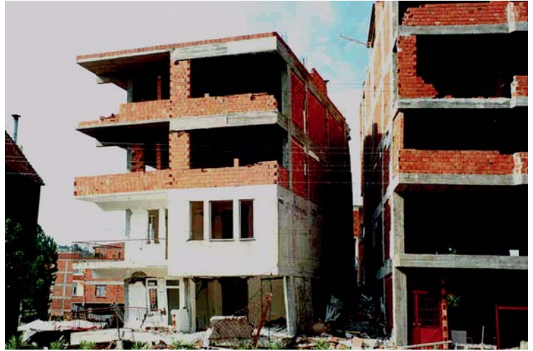
Şekil 8 - Tek cephede dolgu duvarlı binalarda hasar durumu
