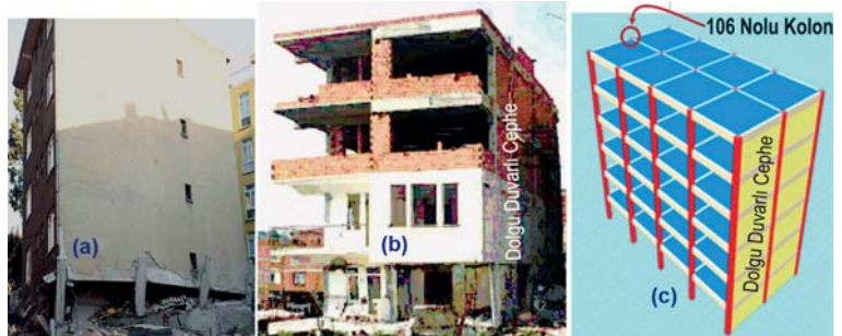
Şekil 9 - (a), (b) Tek cephesi dolgu duvarlı binalarda oluşan deprem hasarları, (c) Tek cephesi dolgu duvarlı binaları temsil eden model
