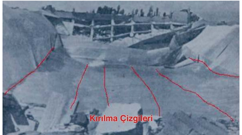
Şekil 6 - Yere Düşmüş Kabuk Yapısındaki Kırılma Çizgileri
