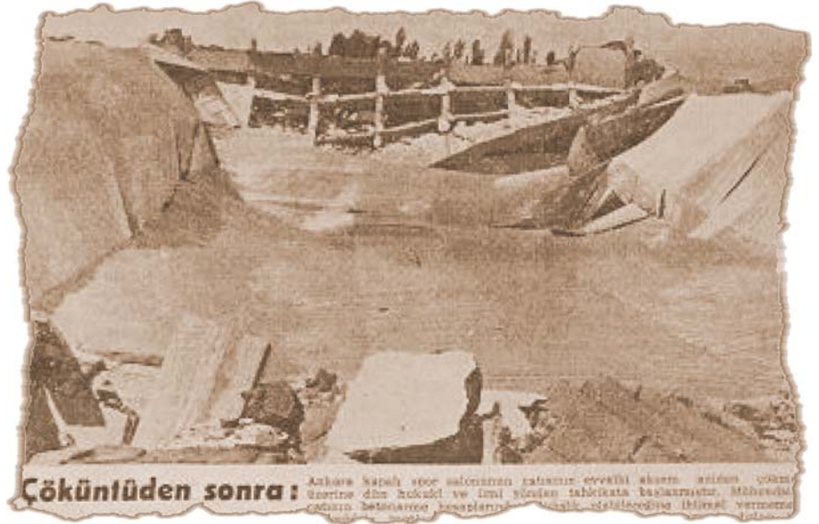
Şekil 1 - Çökmüş Kabuk Çatının Spor Salonunun İçinden Görünüşü (4 Hazi- ran 1958 Hürriyet Gazetesi)
