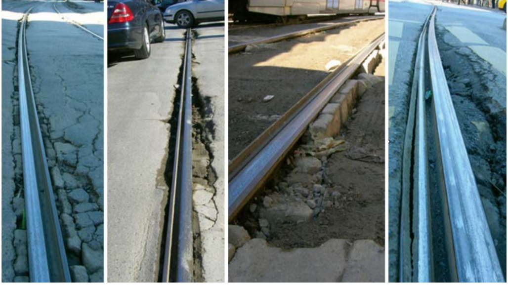
Şekil 9 - Klasik yapım yöntemleri ile yapılan hatlarda (Fransız ve Alman sistemleri ile yapılmış) zamanla üstyapı sorunları yaşamaya başlamış, aşırı vibrasyon ve tasarım hataları sebebiyle bozulan yollardan derlenen örnekler görülmektedir. Bu tip hatlarda üst tabaka ne olursa olsun (üstte asfalt kaplamalar) trafiğe bağlı 20-25 MGT sonunda sorunların ortaya çıktığı, gergi çubuklarının asfaltın içinde kırıldığı, yolun ekartmanının bozulduğu, ray altı taşlarının titreşim ve vibrasyon nedeniyle yerinden oynadığı gözlemlenmiştir.
